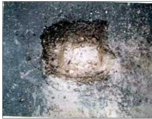
콘크리트의 열화 및 철근부식
