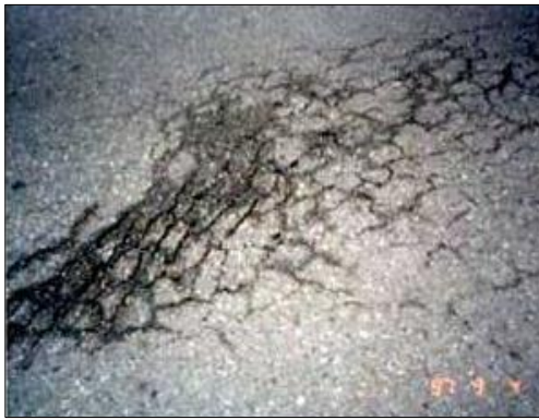
아스팔트의 손상 상태
