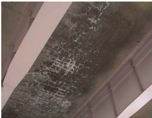
격자형 균열과 백태가 심화된 상태
