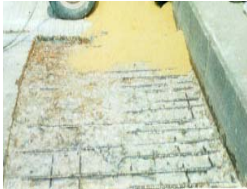
들뜸부 제거 후 철근노출 상태
